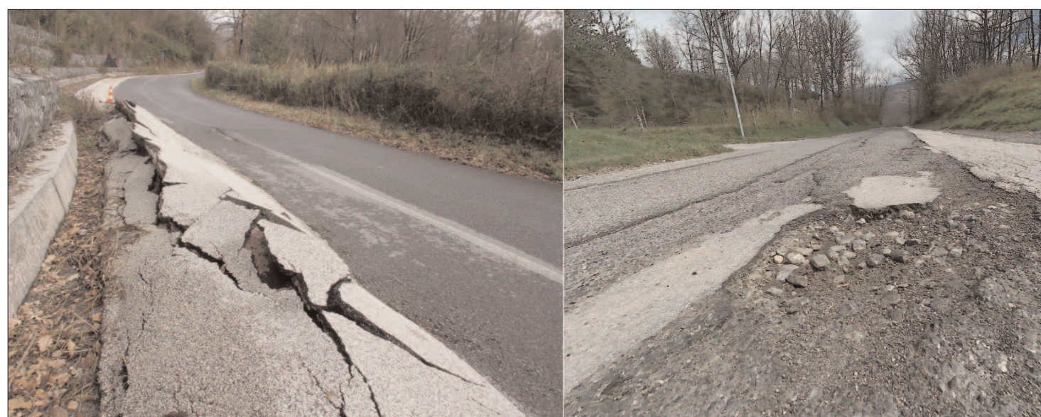
Viabilità a rischio nella Valle del Noce. Nelle foto, due tratti danneggiati della strada che collega Lauria a Nemoli. FOTO: RAFFAELE PAPALEO
